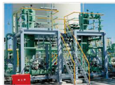
熱量調整装置(出典:九州ガス圧送(株))
