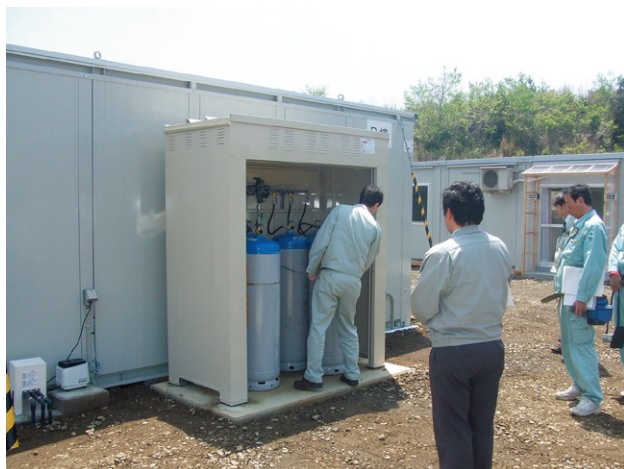
仮設住宅に設置されたLPガス供給設備
