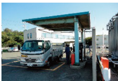
LP自動車充填設備
