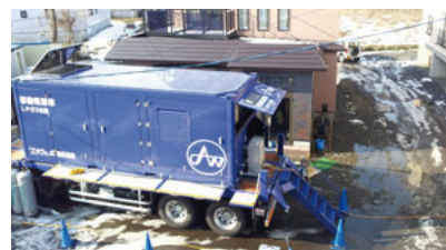
室蘭・登別の大規模停電に移動式電源車が 出動し、介護施設等建物2カ所に 電気を供給しているところ (出典：月刊クオリティ)
